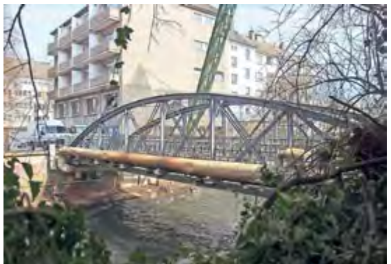
Um diese Brücke geht es: Der Pfälzer Steg soll ab 2020 repariert oder neu gebaut werden.
