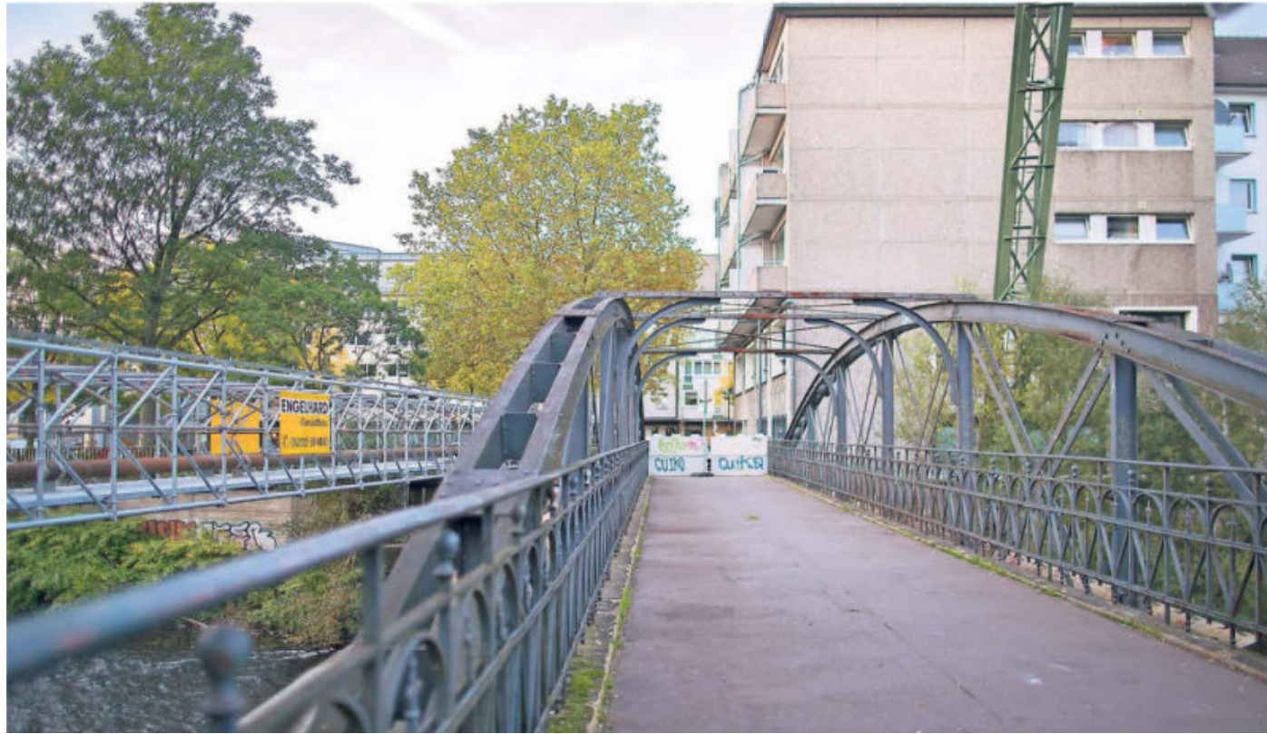
Diesen Blick über die Absperrung wird es nicht mehr lange geben. Der Pfälzer Steg wird bald abgerissen.
