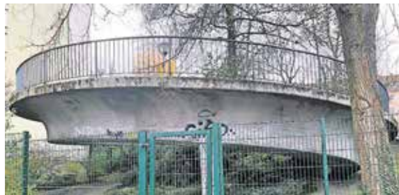
Der Zugang zur Brücke ist abgesperrt. Foto: H.-J. Brester
