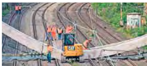
Beim Einsturz der Brücke Ende August 2020 wurden auch Oberleitungen beschädigt. (Archivfoto: Andreas Fischer)
