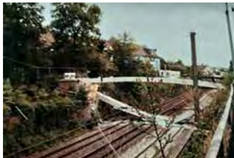
Katastrophe beim Abriss ...
